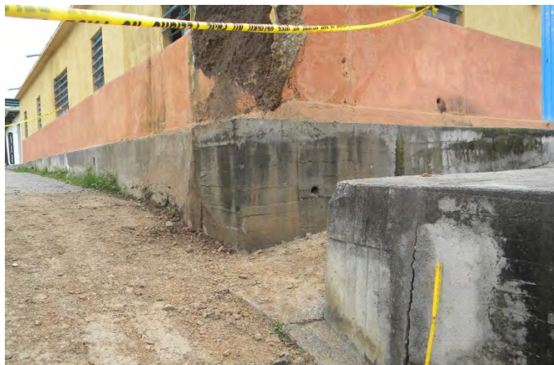
FIGURA 6. Desplazamientos, y deformaciones en el área de estudio
